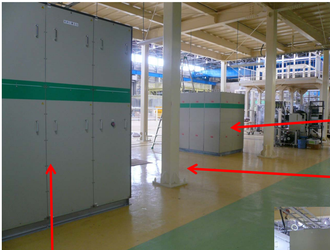
300kW Klystron用電源 (IDX)
