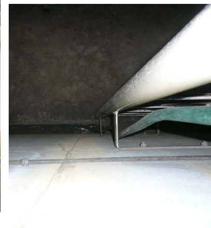
共同溝への排水
