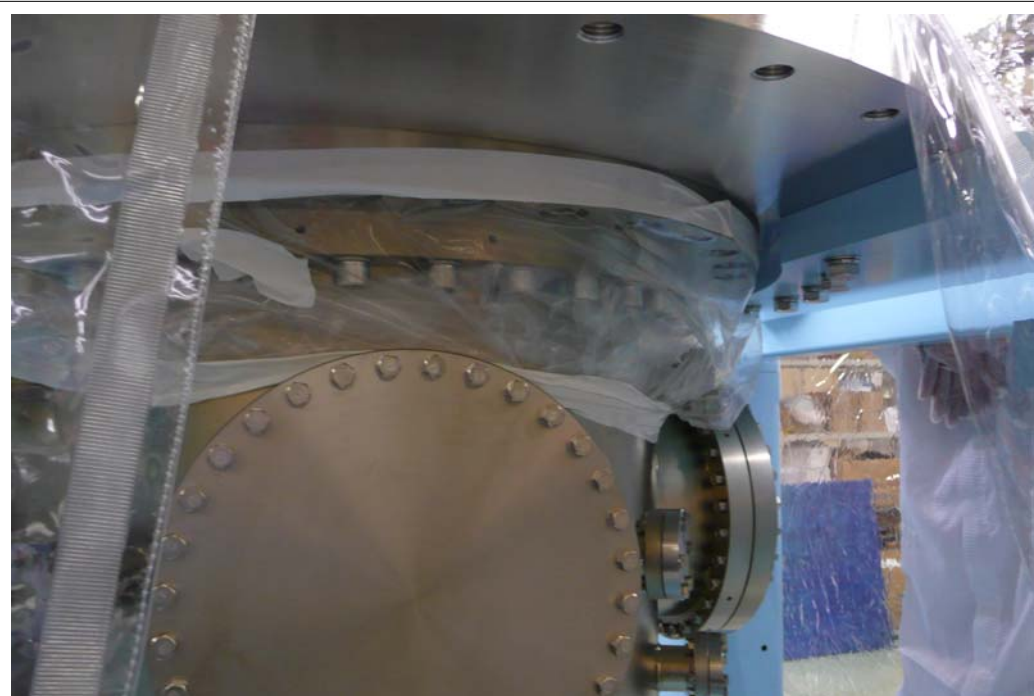
フード法による 720フランジ部のリークテストの様子。交換前に増し締め150N.mでもフード法10分で 1E-11 Pa.m 3 /sのリークがあった。
