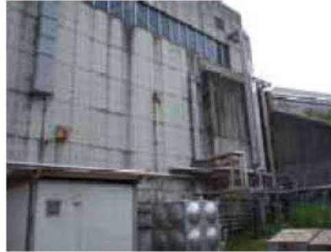
[外壁漏水状況 1]
