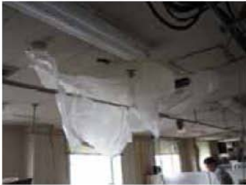
[天井漏水状況]
